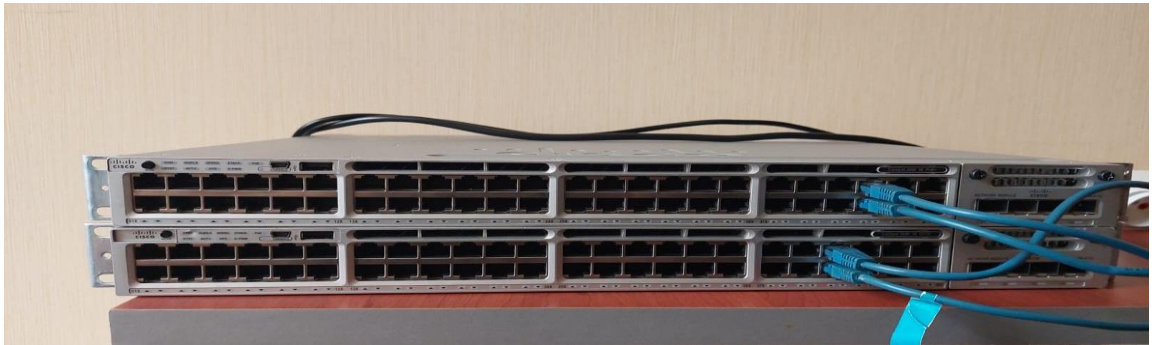
Şəkil 3. 1. Cisco stack switchlər
