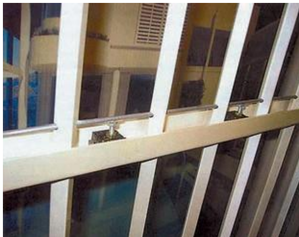
Şəkil 1.9. Sistemin xüsusi metal hasara quraşdırılmış sensor kabeli
