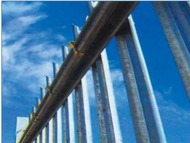
Şəkil 1.3. "Palisade" tipli ağır bir hasarda quraşdırılmış sensor kabeli
