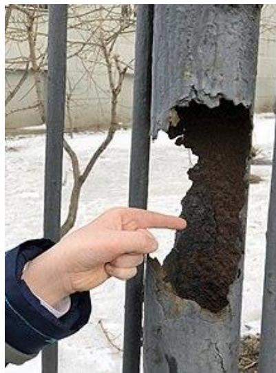
Şək.1.5. Qeyri-bərabər atmosfer korroziyası
