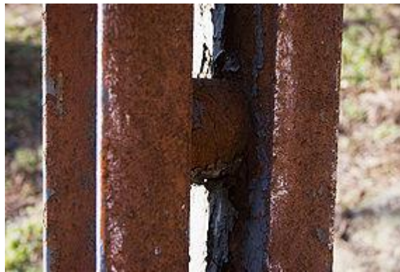
Şək.1.4. Moskvada Şuxov qülləsi konstruksiyasının korroziyası
