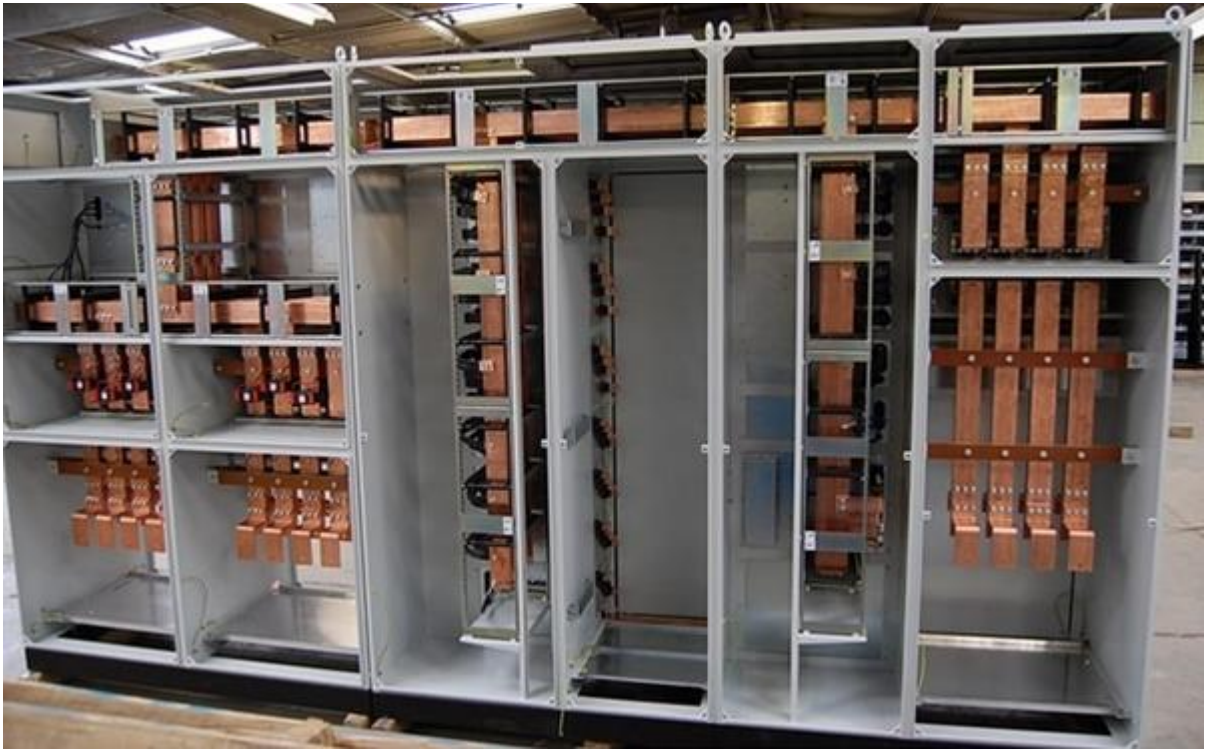
Şəkil. 4.12. 0.4kV şin sistemi.
